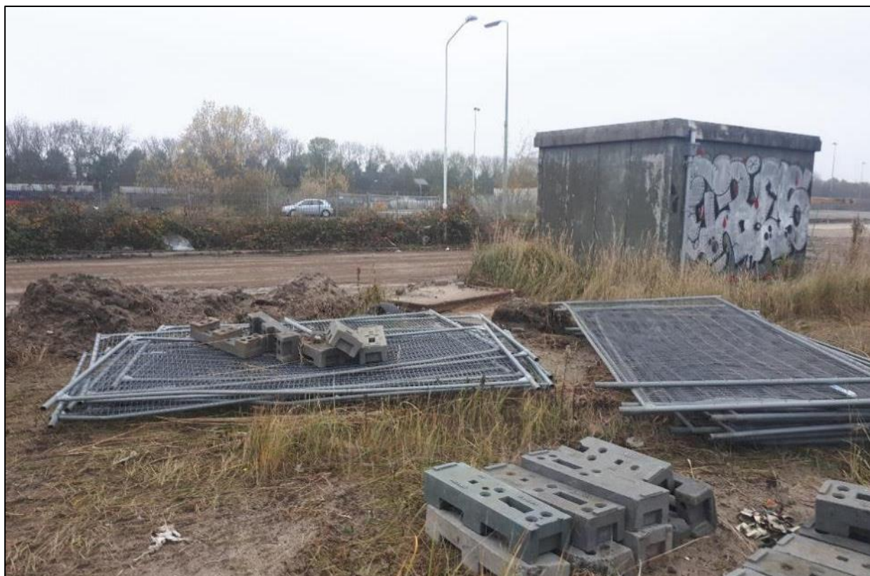
Figuur 4: transformatorhuis geheel geïsoleerd gelegen te midden van het projectgebied. Op de achtergrond bevinden zich lijnvormige structuren welke kunnen dienen als vliegroute voor vleermuizen. Deze bevinden zich buiten de begrenzing van het projectgebied en buiten de invloedsfeer van de voorgenoemde werkzaamheden.
