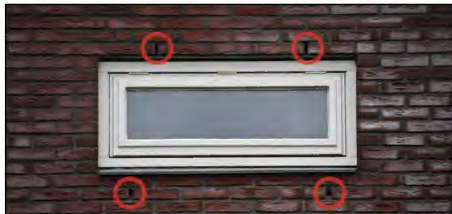
Figuur: detail van de aangrenzende gevel aan de noordzijde van het plangebied. Er zijn diverse open stootvoegen aanwezig (rode cirkels). Hierdoor kunnen vleermuizen de spouw bereiken waar zij verblijfplaatsen kunnen hebben.
