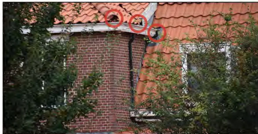
Figuur: de omliggende woningen met pannendaken hebben op diverse plaatsen openingen (rode cirkels). Hier kan huismus onder tot broeden komen en vleermuizen kunnen via deze openingen ruimtes in het dak bereiken waar zij verblijfplaatsen kunnen hebben.
