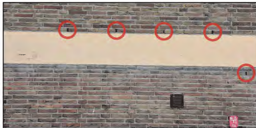
Figuur: detail van de oostgevel van het pand ten westen van het plangebied. Hier zijn diverse open stootvoegen aanwezig (rode cirkels) die vleermuizen toegang verschaffen tot de spouw waar ze verblijfplaatsen kunnen hebben.
