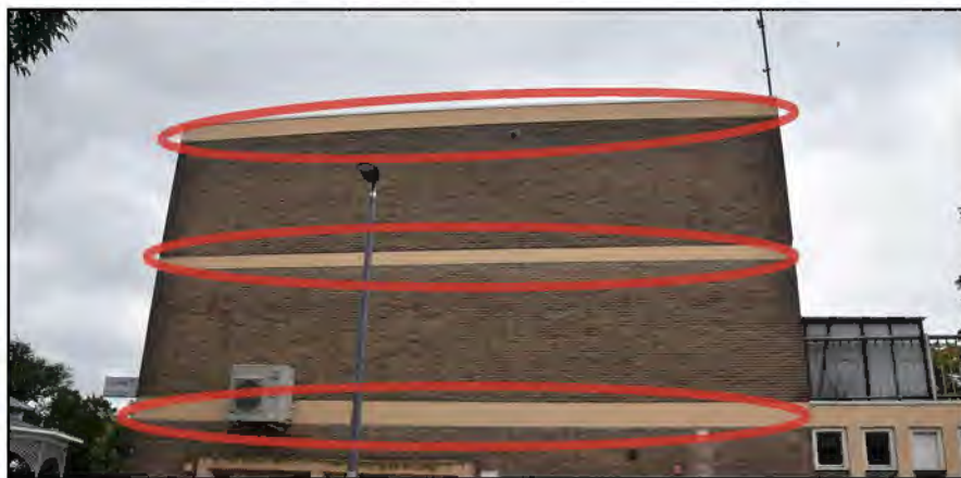
Figuur: in de omliggende gebouwen zijn op diverse locaties open stootvoegen aanwezig. Op de kopgevel van het pand ten westen van het plangebied zijn diverse open stootvoegen aanwezig (rode cirkels). Inzoomen vergroot de zichtbaarheid van de open stootvoegen.
