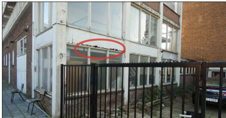
Figuur: Houten beplating, ter hoogte van de eerste verdieping aan de zuidwestzijde van het gebouw, waarin gaten aanwezig zijn wat betreding van de bebouwing door de huismus en broedvogels mogelijk maakt.
