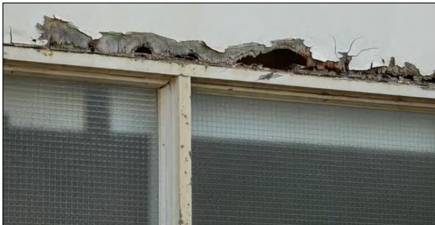
Figuur: Close-up van de verweerde houten beplating .
