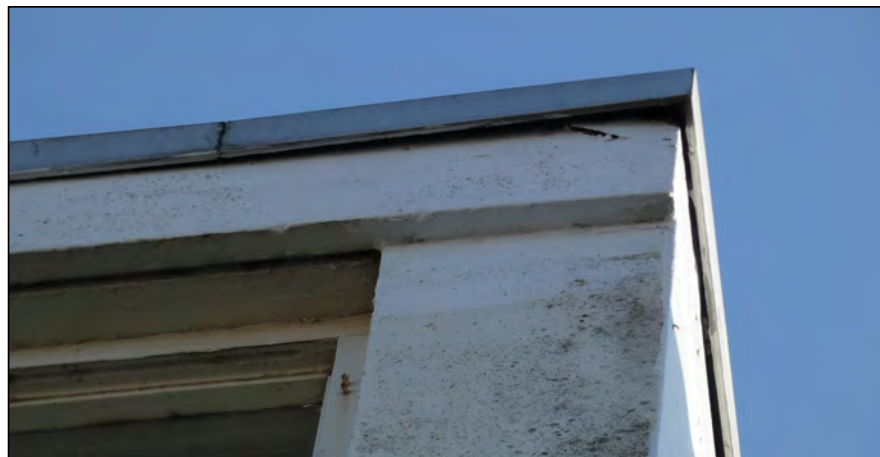
Figuur: Op verschillende plekken is er ruimte tussen de dakrand en de houten gevelplaten aanwezig, welke vleermuissoorten kunnen benutten als verblijfplaats (voorbeeld 3).
