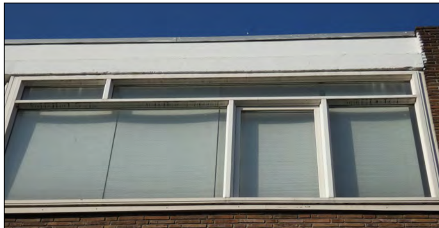
Figuur: Op verschillende plekken is er ruimte tussen de dakrand en de houten gevelplaten aanwezig, welke vleermuissoorten kunnen benutten als verblijfplaats (voorbeeld 2).
