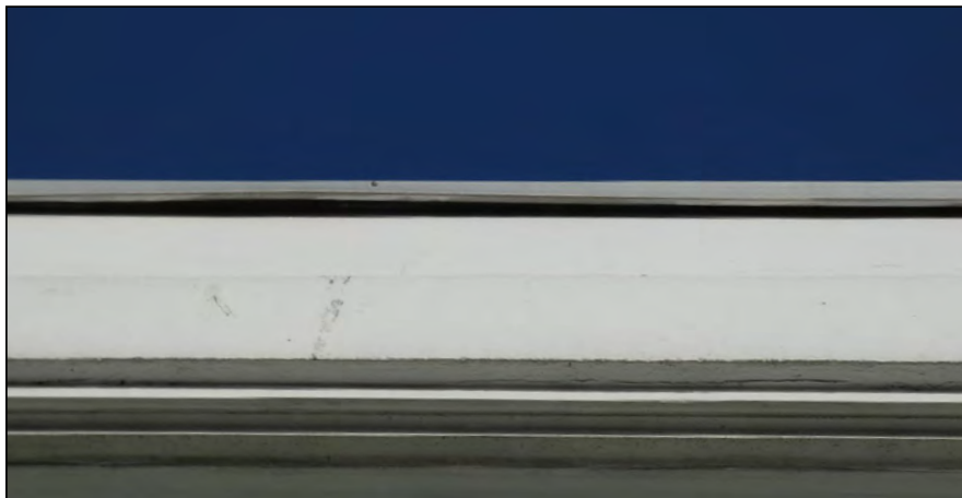
Figuur: Op verschillende plekken is er ruimte tussen de dakrand en de houten gevelplaten aanwezig, welke vleermuissoorten kunnen benutten als verblijfplaats (voorbeeld 1).
