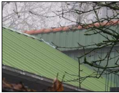
Figuur 9. Dak gezien vanaf de Dordtsestraatweg, kijkrichting naar het zuiden. Zichtbaar zijn overhangende kantpannen.
