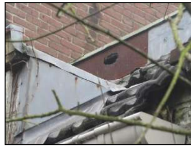
Figuur 11. Dak met gat in lijst gezien vanaf de achterzijde, kijkrichting naar het noordoosten.
