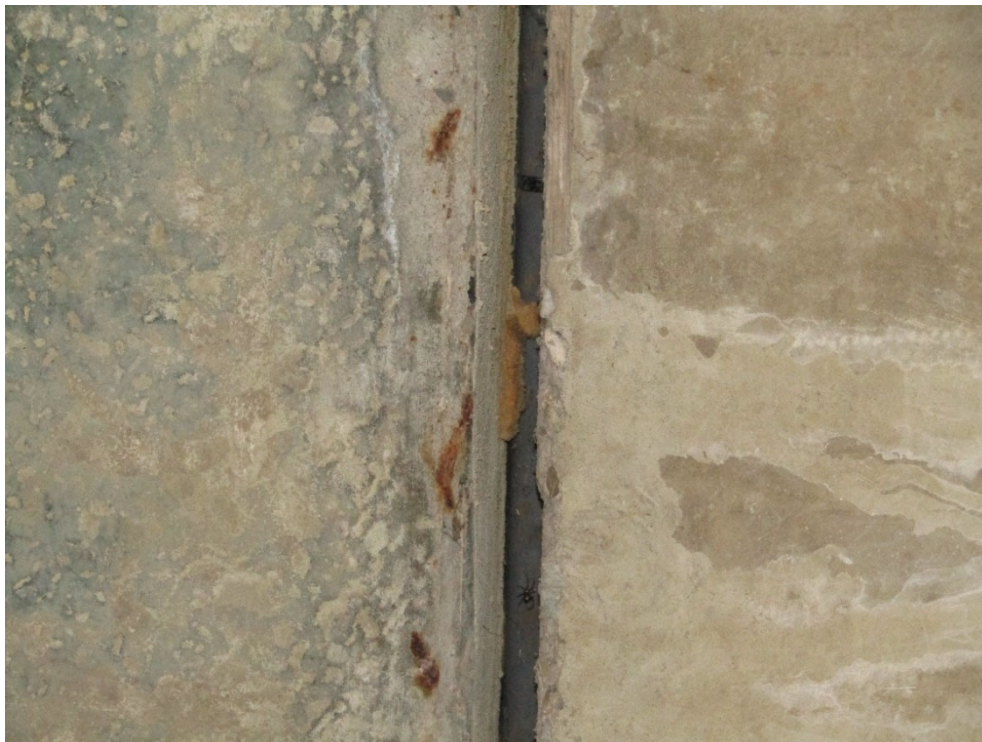
Figuur 14: dit soort kieren worden veelvuldig aangetroffen in muren en plafonds van de basculekelder en ook in pijler 9 en 10. Hier zijn geen overwinterende vleermuizen waargenomen tijdens het veldbezoek op 13 december 2019.
