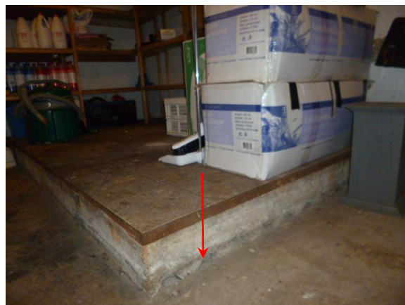
foto 2: opstort, C.V.-ruimte kelder golfplaat M02- asbesthoudend
