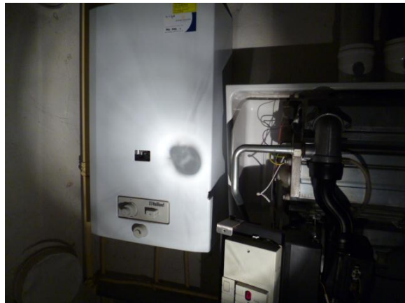
foto 3: C.V.-ruimte C.V.-installatie en geiser – niet asbestverdacht
