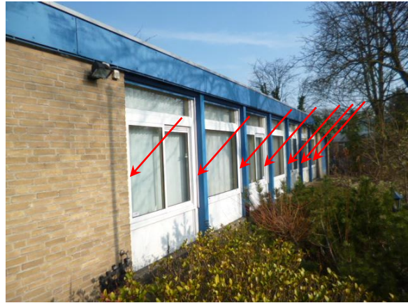
foto 2: gevel entreezijde kit M11- asbesthoudend
