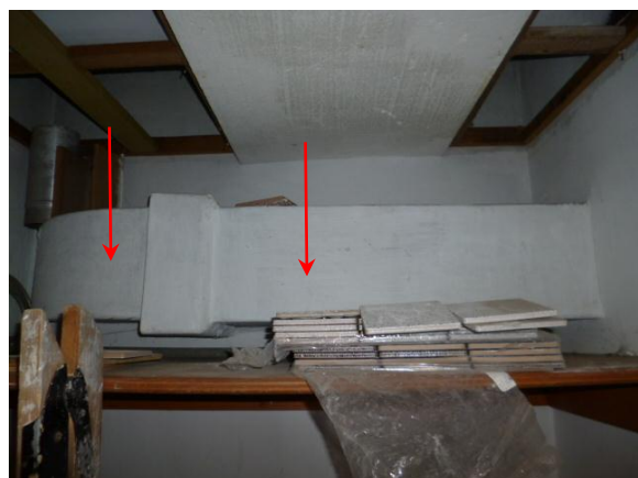
foto 3: berging kelder ventilatiekanaal M03- asbesthoudend
