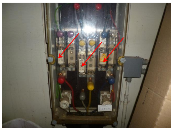
foto 5: meterkast meszekering V01- asbestverdacht
