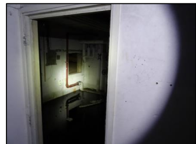
Figuur 8. Inlooptkelder, volgelopen met water.
