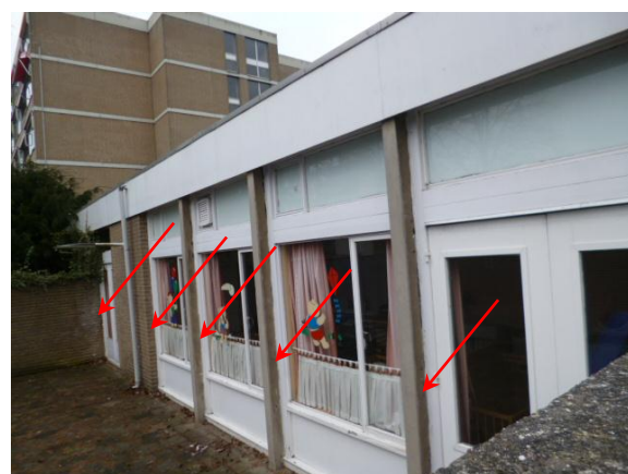
foto 4: gevel buitenzijde kit M04- asbesthoudend
