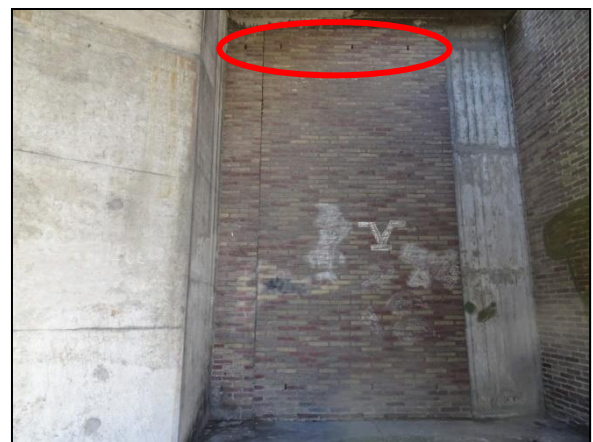
Figuur 25. Open stootvoegen in de bakstenen muur gelegen aan de voet van de silo's.
