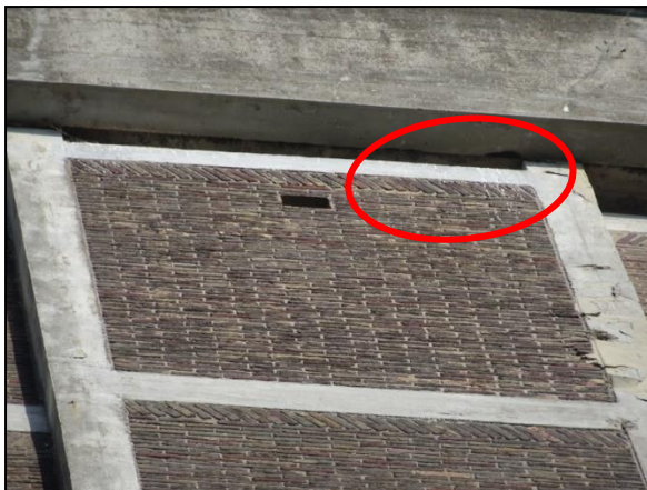
Figuur 22. Detailfoto van de betonnen daklijst bovenaan de liftschacht. Aan de onderzijde van de daklijst is een opening zichtbaar met krijtstrepen eronder (aangegeven met de rode cirkel).
