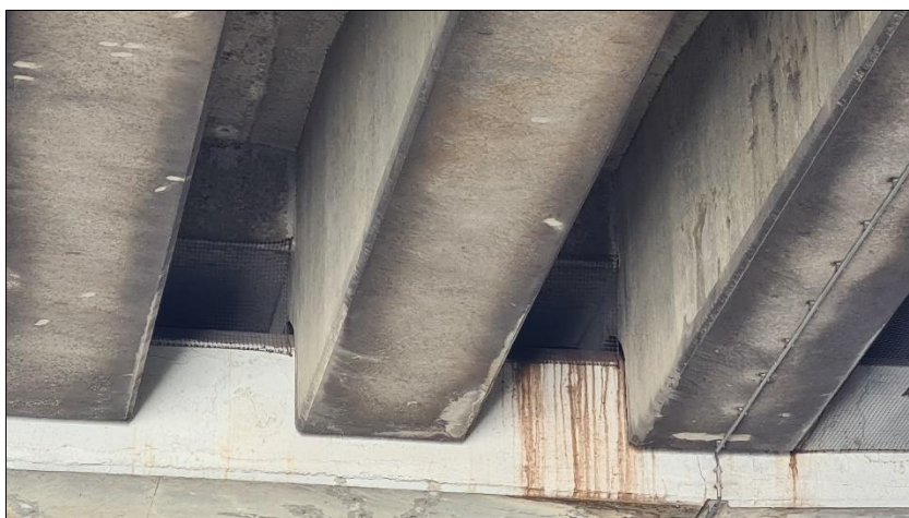
Figuur 3. Voor nissen onder de metrobaan zijn netten gespannen.
