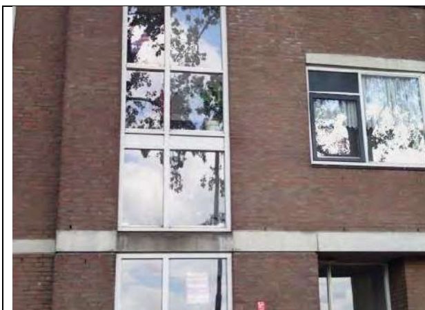
e) gevel Hilledijk met open stootvoegen
