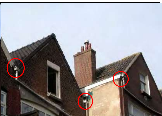
d) pannendaken met kieren bij tuingevel
