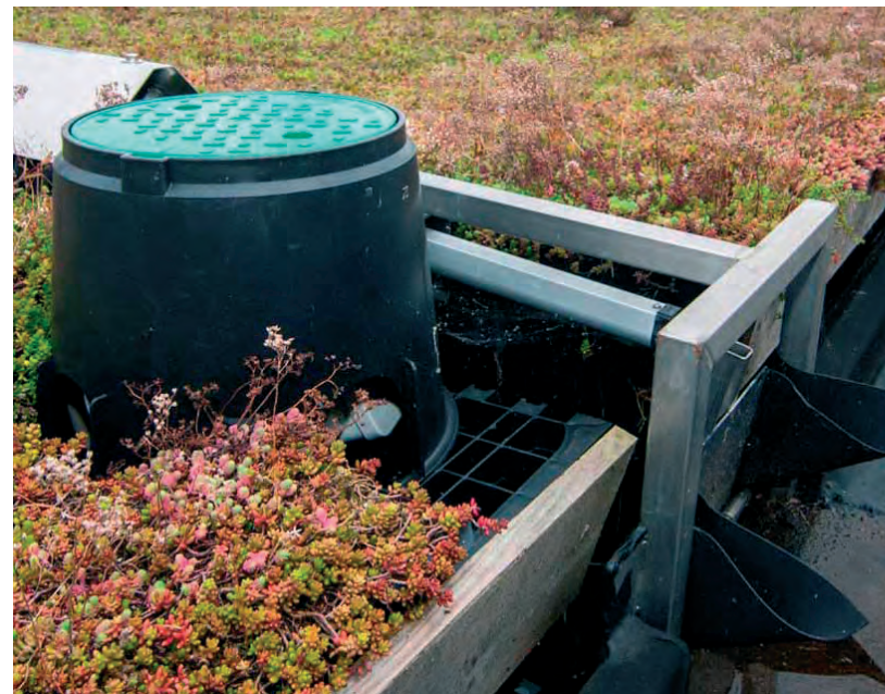
Polderdak met automatisch regelsysteem
