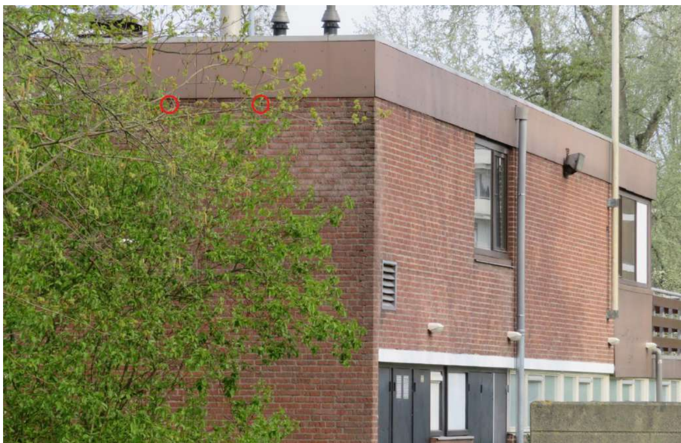
Fig. 8: Open stootvoegen achter boom in gebouw 1.
