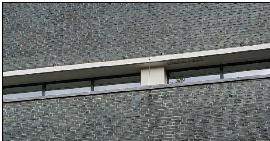
Figuur: ook in omliggende, niet te slopen gebouwen kunnen vleermuizen voorkomen. Dit gebouw heeft open stootvoegen waardoor er voor vleermuizen toegang tot de spouw is.
