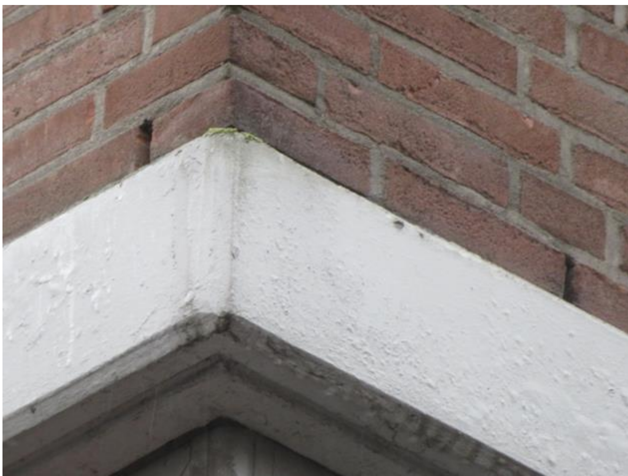
Open stootvoegen op elke verdieping van het flatgebouw Achterharingvliet even nummers
