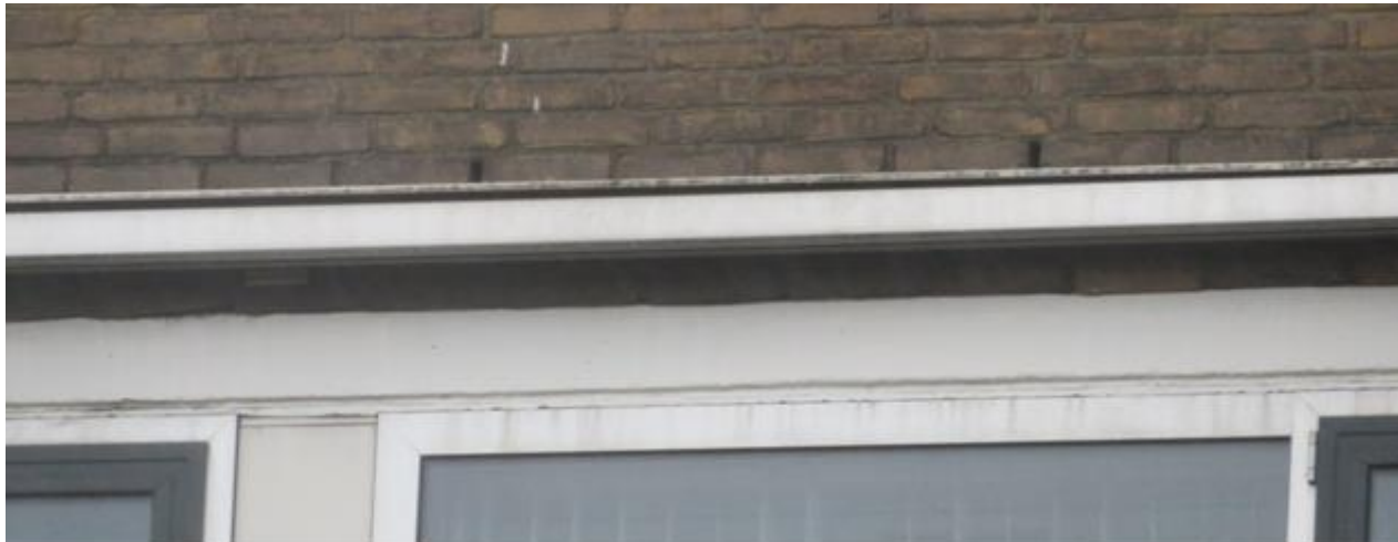
Open stootvoegen aan voorzijde gedeelte westelijk van beeldbepalende deel
