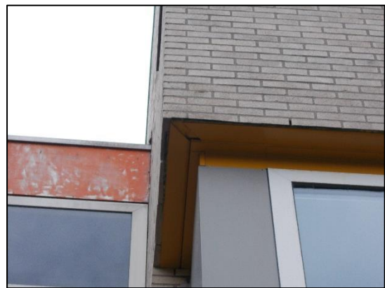
Foto 8: Open stootvoegen in gebouw D
