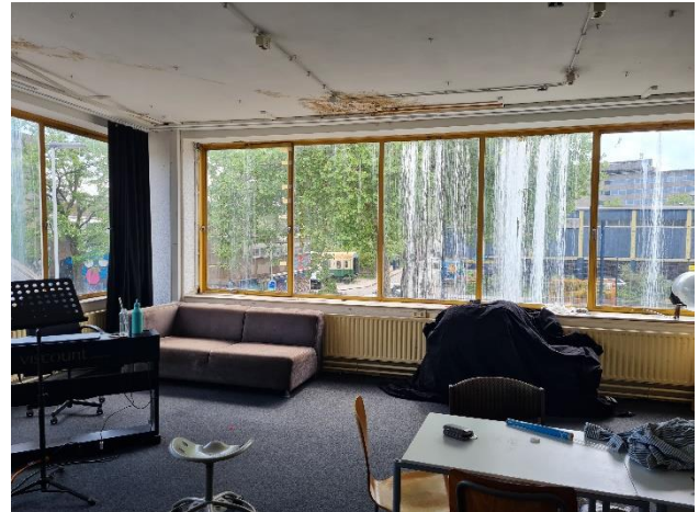
Eerste verdieping hoek achterzijde/ linkergevel. Daklekkages geconstateerd. Bij de kozijnen corrosievorming geconstateerd en de betonnenborstwering met keramische vensterbanken zijn ontzet. Zie volgende foto's.
