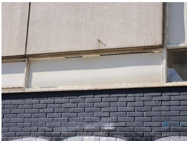
Met regelmaat ontbrekend stopverf bij de kozijnen
