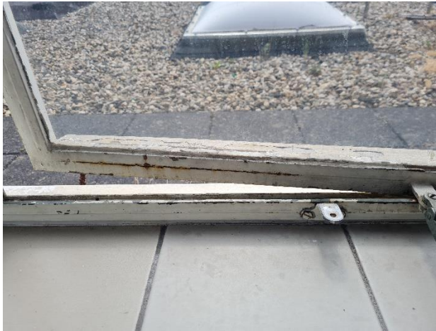
Aantasting corrosie aan binnenzijde taatsraam
