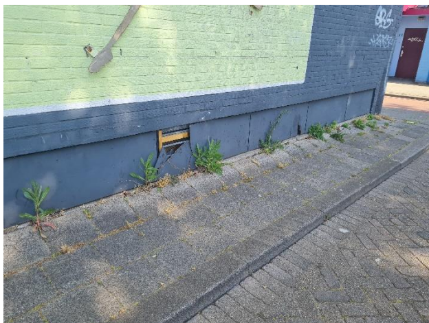
Verzakking straatwerk aan achterzijde.
