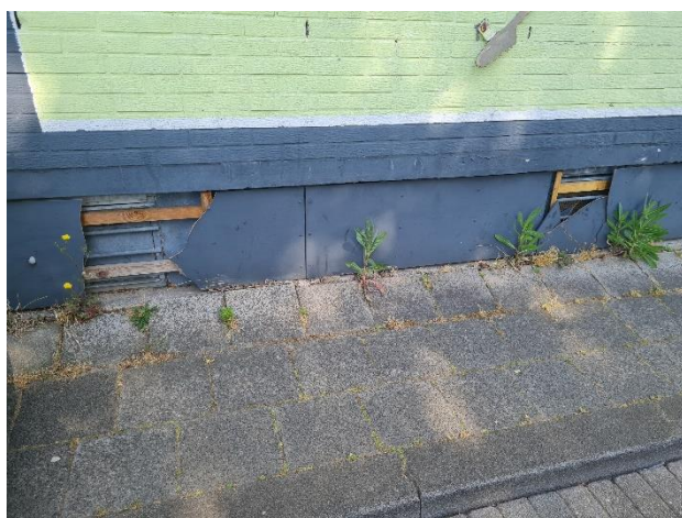
Diverse aanrijdschades geconstateerd aan kunststof gevelbeplating.
