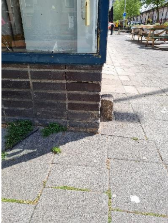
Beschadigd metselwerk hoek Vijverhofstraat – Teilingerstraat.
