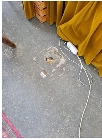
Asbest in o.a. vloerconstructie. Voor overige asbest zaken zie rapportage RPS.
