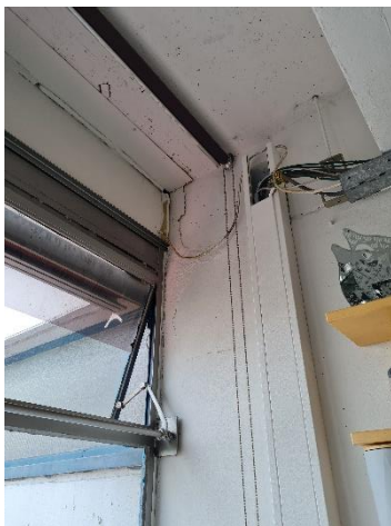
Scheurvorming bij aansluiting kolomconstructie en gevel op de 4 e verdieping achter de liften.
