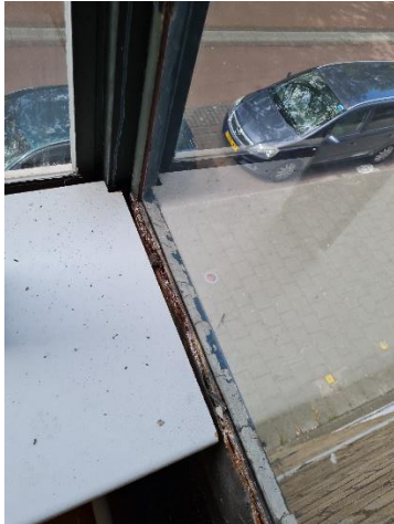
Aantasting corrosie aan binnenzijde kozijn.
