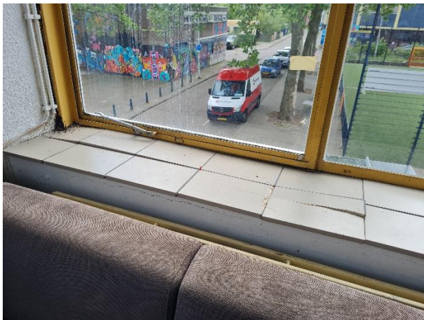
Vensterbanken op borstwering komen los door onderliggende scheurvorming in de borstwering.
