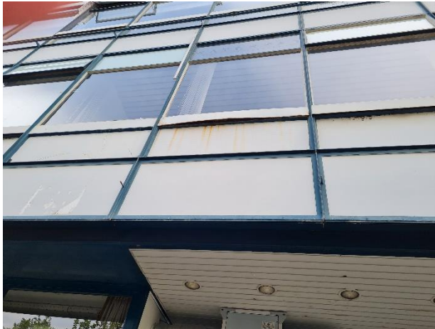
Met regelmaat zijn de kozijnen van het bouwdeel Vijverhofstraat dusdanig gecorrodeerd dat herstel niet mogelijk is.
