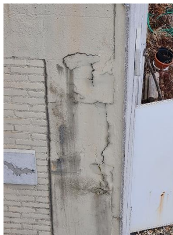
Op diverse plaatsen aantasting van de betonnen gevel noodtrappenhuis. Betonrotherstel toepassen.
