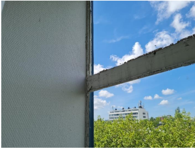
Met regelmaat corrosie aangetroffen aan de binnenzijde van het pand.
