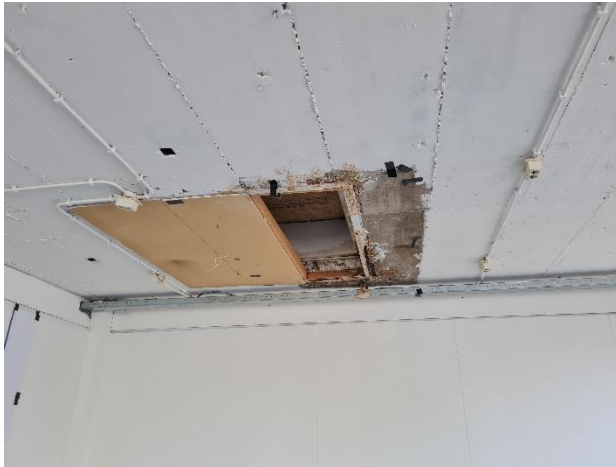
Lekkage sporen bij oude daglichttoetreding vanaf het lage dakvlak. Meerdere lekkages vanaf dit dak waargenomen.
