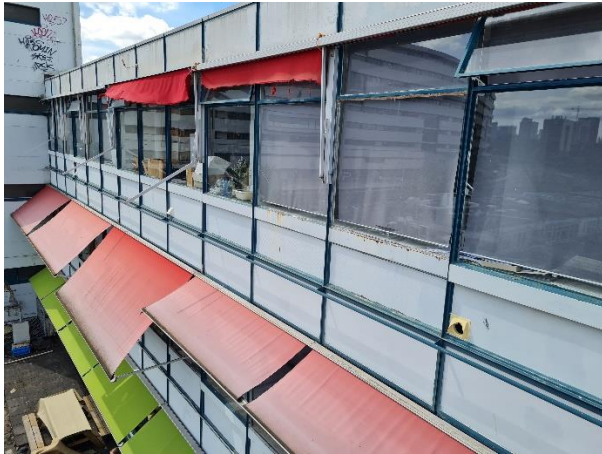
Zonwering verkleurd en aanzienlijk beschadigd over de gehele achtergevel.
