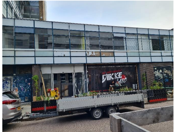
Coating op draadglas bladdert af en diverse ramen zijn beschadigd.
