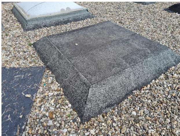
Bitumen vertoont craquele in een gevorderd stadium en heeft nog een beperkte levensduur.
