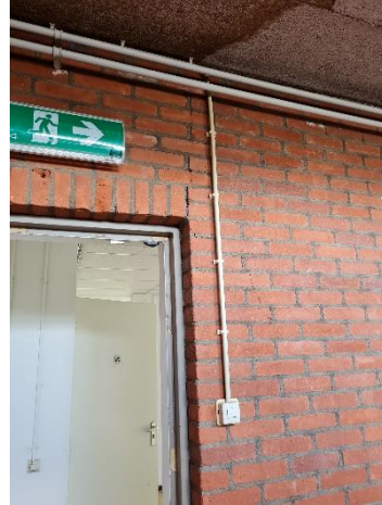
Scheurvorming aangetroffen in niet dragende muur noodtrappenhuis.
