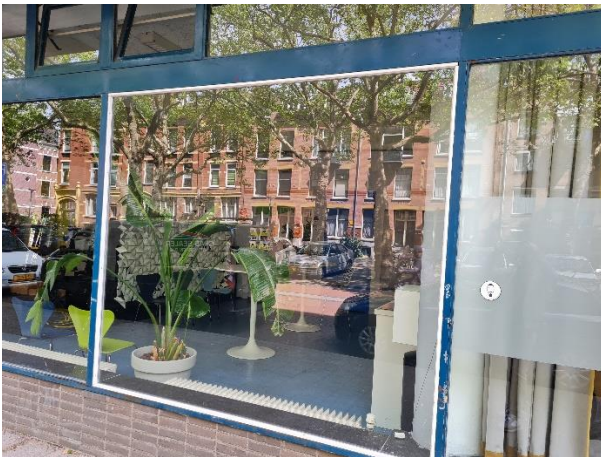
Diverse alternatieve herstelwijzen toegepast voor glaslatten, waardoor het kozijn niet meer origineel is. Toepast materiaal is aluminium en houten glaslatten op de stalen pui en gebruik van stopverf.
