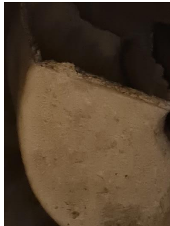
Asbest verdacht materiaal aangetroffen op 1 e verdieping bij keuken/ toiletten met breuk. Is niet terug gevonden in de rapportage van RPS.
