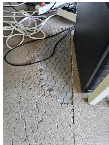
Beschadiging toplaag betonvloer 1e verdieping.
