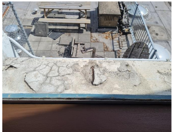
Barsten en afbladderen stucwerk op betonnen waterslagen bij de kozijnen trappenhuis. Betonrot herstel toepassen.
