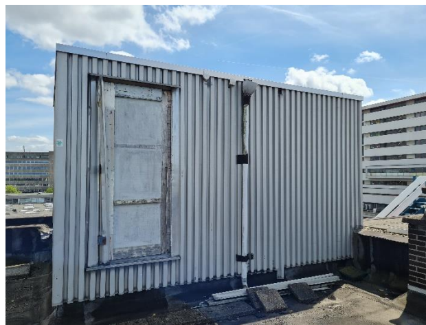
Deur beschadigd aluminium dakopbouw.
