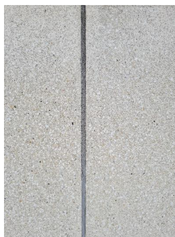
De dilatatievoegen tussen de betonplaten zijn uitgehard en dienen vervangen te worden om inwatering via de spouw te voorkomen.
