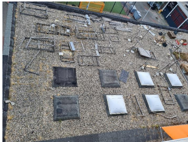
Lage dak vervuild met materiaal dat kan zorgen voor vervolgschades bij onstuimige weersomstandigheden.
