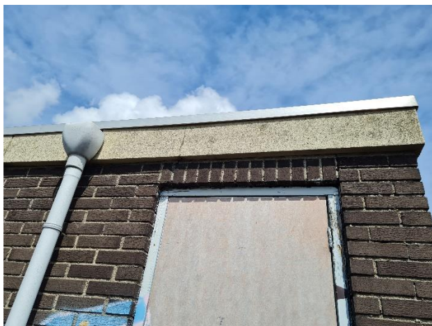
In de dakplaat van de dakopbouw is een scheur geconstateerd.
