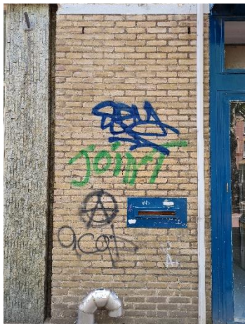
Scheur in gevelmetselwerk buiten spouw tussen linker en recht gebouw aan de Teilingerstraat. Aan binnenzijde en kelder geen gebreken geconstateerd.
