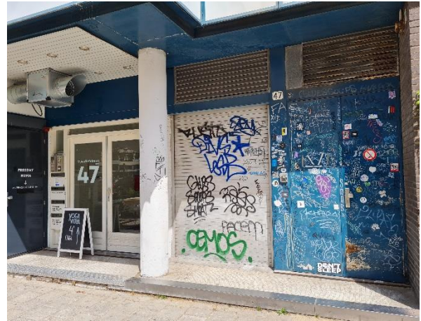
Aangetast beton bij kolom entree deur Vijverhofstraat.
