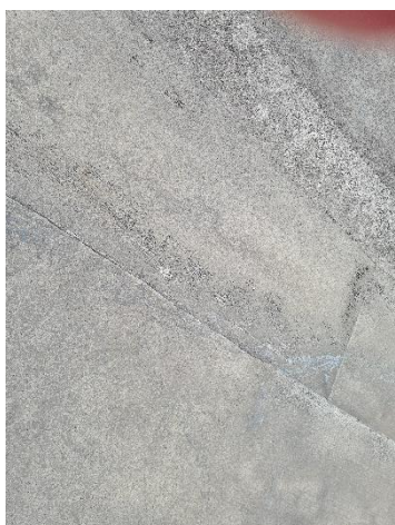
Plaatselijk verwerking bitumen aangetroffen toplaag door zonsinvloeden.
