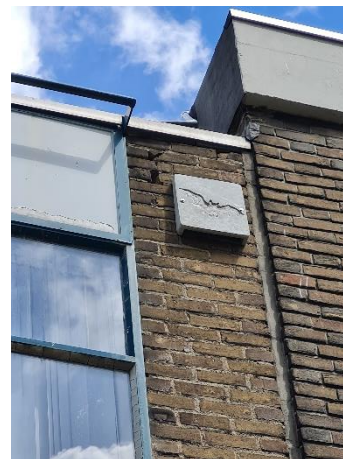
Scheurvorming bij gevel/dakaansluiting door zetting gebouw of waterschade vanaf het dak. Dit dient nader onder zocht te worden en hersteld te worden.
