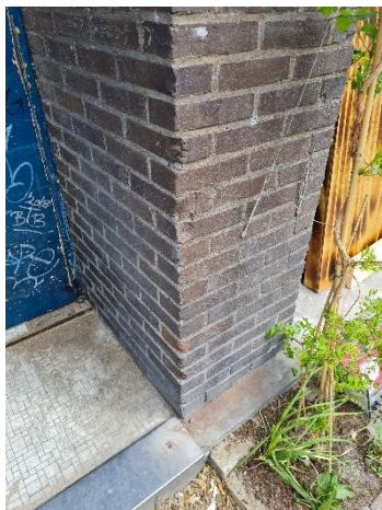
Metselwerk Vijverhofstraat gevel plaatselijk beschadigd. Betreft alleen esthetisch
