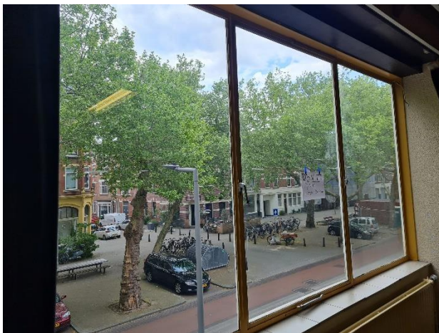
Deel van de kozijnen nog in redelijke staat van onderhoud
