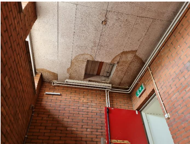
Oude lekkagesporen op 4 e verdieping in noodtrappenhuis. Luik naar bovenliggend deel niet geïnspecteerd ivm de toegang.
