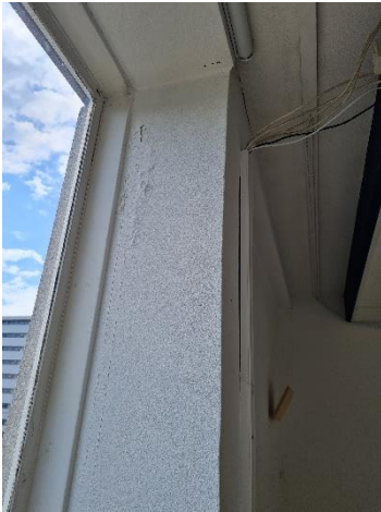
Vochtschades aangetroffen op 4 e verdieping bij gevelkozijn aansluiting.
