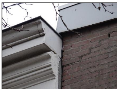
Figuur 25. Detailfoto van open dilatatievoeg en spleet tussen boeiboord en muur aan de Teilingerstraat 14-46.
