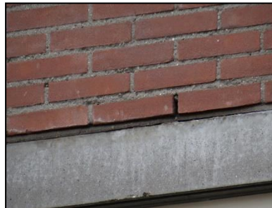
Figuur 11. Detailfoto van open stootvoeg boven het raam van Zomerhofstraat 6-18.
