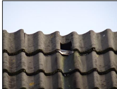
Figuur 8. Detailfoto van gat in dakpan van Almondestraat, met ontstane toegang tot ruimte onder de dakpannen.
