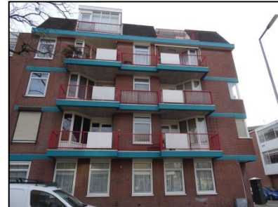
Figuur 9. Overzichtsfoto van Almondestraat 251-283 met openingen tot ruimte achter boeiboorden.
