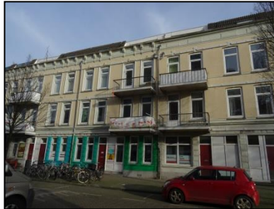
Figuur 7. Overzichtsfoto van Almondestraat 145-171 met losse gevelbeplating en ruimte onder dakpannen.
