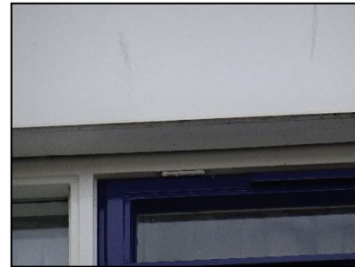
Figuur 18. Detailfoto van spleet tussen boeiboord en muur van het woningblok (zie figuur 16) met ontstane toegang tot ruimte achter het boeiboord.
