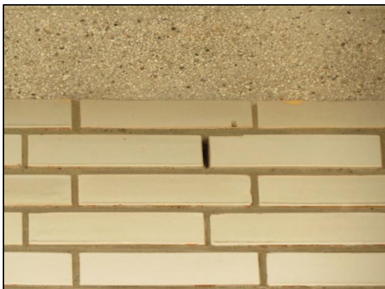
Figuur 5 Open stootvoegen kantoorpand.
