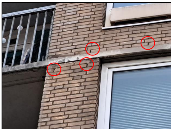
Figuur 3 Open stootvoegen appartementencomplex.
