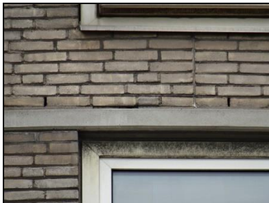
Figuur 12. Open stootvoegen in het metselwerk.
