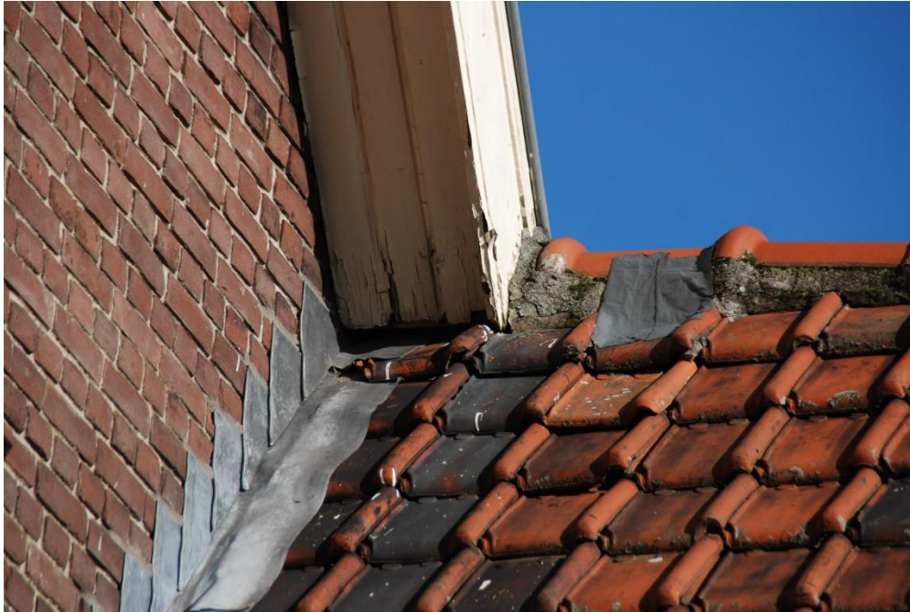
3 Detail dak. Hier is ruimte tussen de muur en het dakoverstek te zien geschikt voor vleermuizen en eventueel huismussen en gierzwaluwen.
