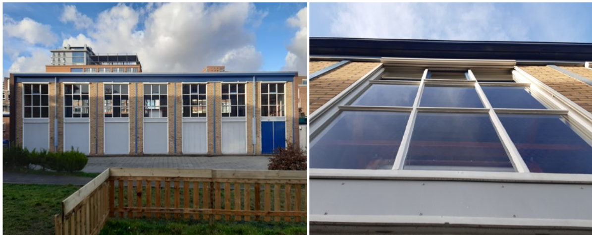
Afbeelding 15 en 16: Zonneweringen raampartijen zuidzijde en locaties aangetroffen vleermuis uitwerpselen
