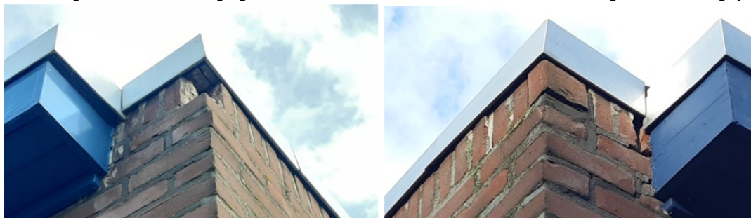
Afbeelding 11 en 12: Beschadigingen en kieren drietal hoeken in het baksteen bieden geschikte invliegopeningen
