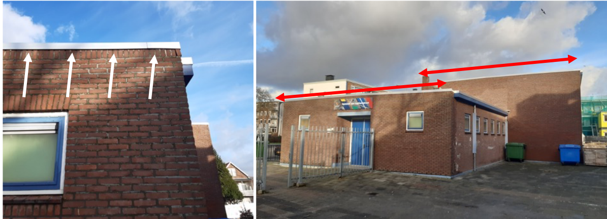
Afbeelding 13 en 14: Toegankelijke kieren tussen aluminium daklijsten en bakstenen muurdelen
