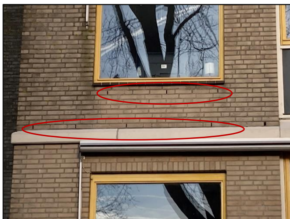
Figuur 35 Bebouwing aan de noordzijde van het plangebied met open stootvoegen (rood omcirkeld).
