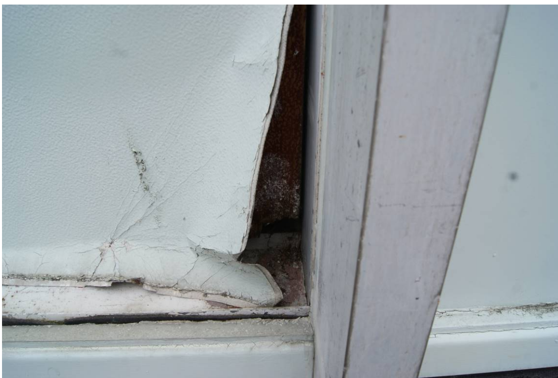
Figuur 2: opengescheurd/gebroken deel van de buitenwand (zichtbaar is een houten plaat)
