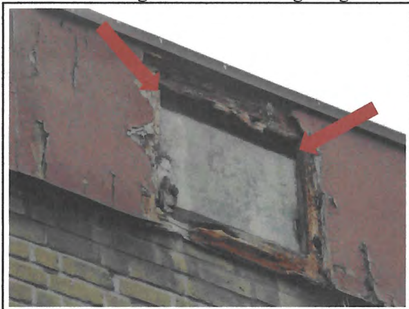
Foto 13: beschadigde dakrandafwerking kerkgebouw
