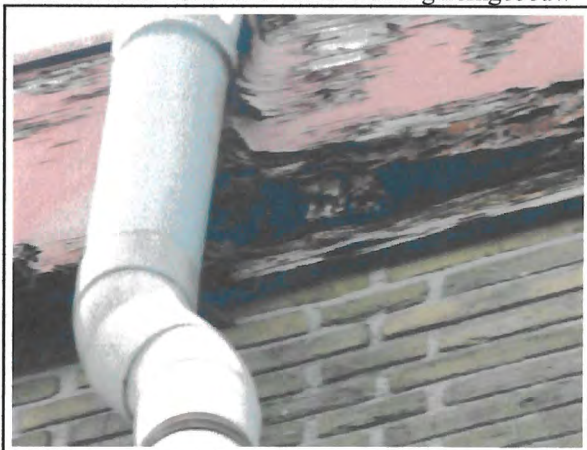
Foto 12: sterk verweerde dakafwerking kerkgebouw
