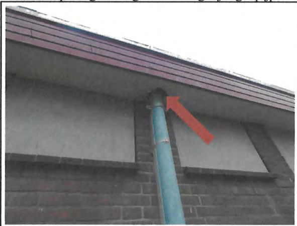
Foto 27: opening in dakgootbekisting bij regenpijp
