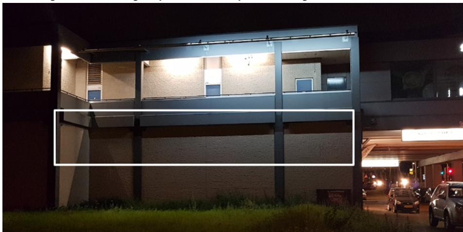
Afbeelding 4. De verlichting ter plaatse van de open stootvoegen
