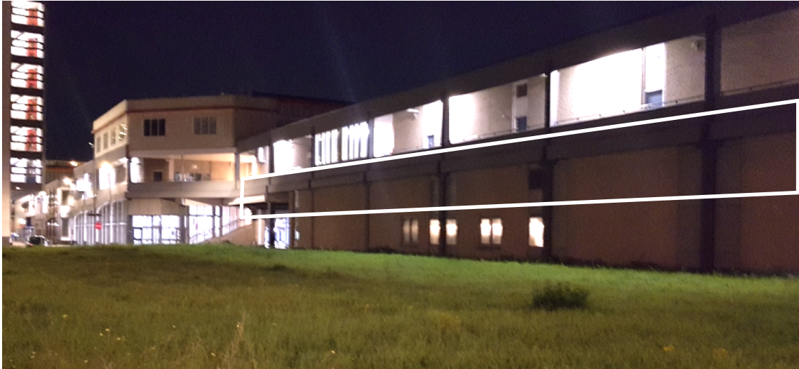
Afbeelding 5. De verlichting ter plaatse van de open stootvoegen
