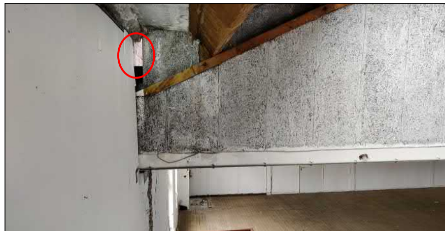
Figuur: in de zijkant van het gebouw is er een opening naar binnen toe aangetroffen. Vogels kunnen in de opening broeden of binnen het gebouw tot broeden komen.
