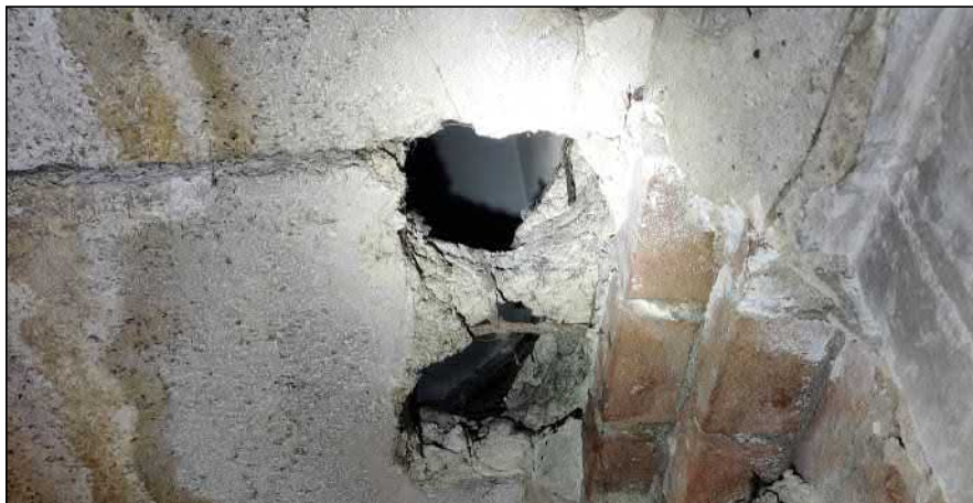
Figuur: binnen het gebouw zijn er diverse gaten in de muren aangetroffen. Hierdoor kon vastgesteld worden dat er een spouwmuur aanwezig is waar vleermuizen verblijfplaatsen in kunnen hebben.
