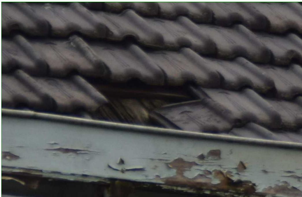
Kieren in de dakrand en onder dakpannen geven jaarrond beschermde broedvogels mogelijk toegang tot geschikte nestholtes.
