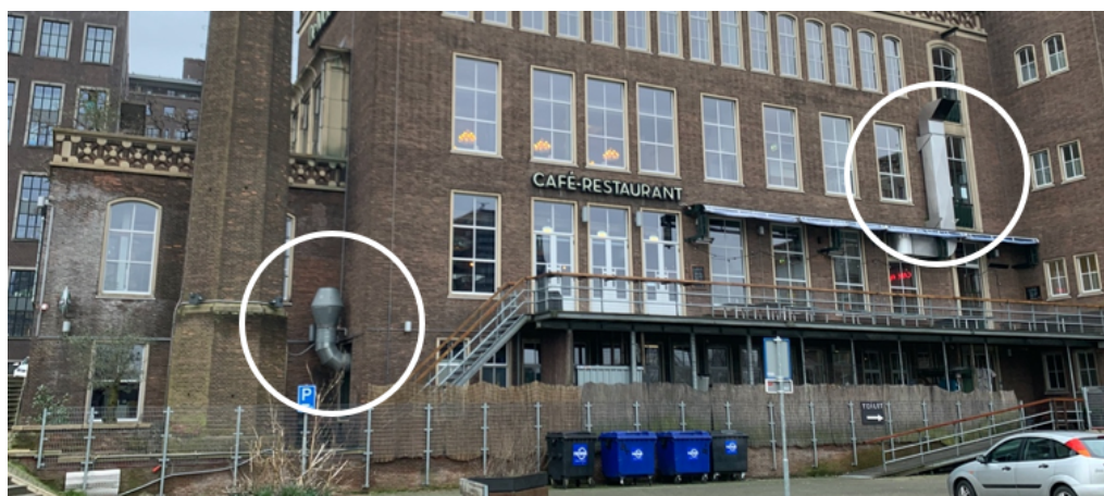
Figuur 3 De Machinist: technische installaties
