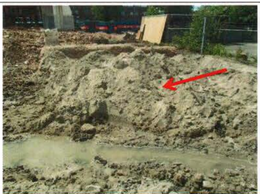
Foto 3. Asbesthoudende restanten visueel waargenomen
