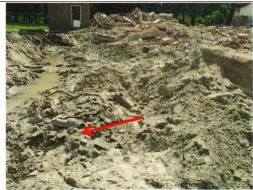
Foto 2. Asbesthoudende restanten visueel waargenomen
