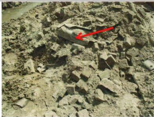
Foto 1. Asbesthoudende restanten visueel waargenomen
