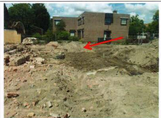
Foto 4. Asbesthoudende restanten visueel waargenomen
