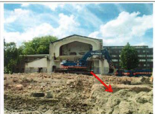
Foto 6. Asbesthoudende restanten visueel waargenomen
