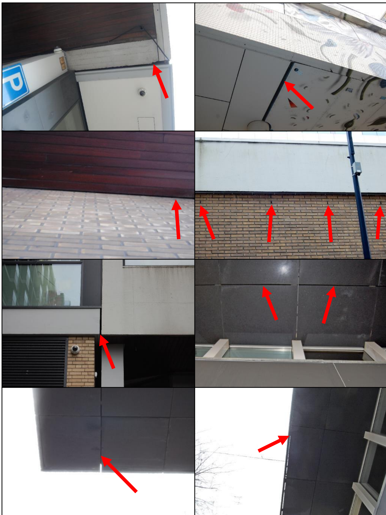
Voorbeelden van spleten, gaten en kieren (rode pijl) die mogelijk toegang geven tot voor vleermuizen geschikte achterliggende ruimtes.
