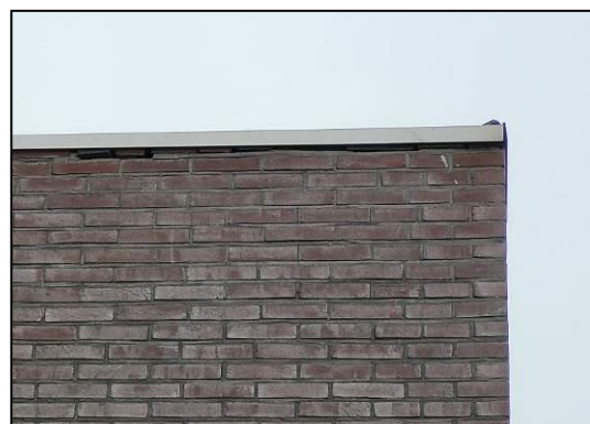
Afbeelding 4: Dakrand met afstaande stalen daklijst
