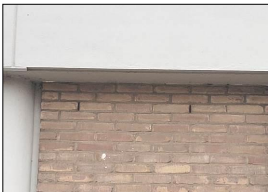
Afbeelding 3: Open stootvoegen in gevel
