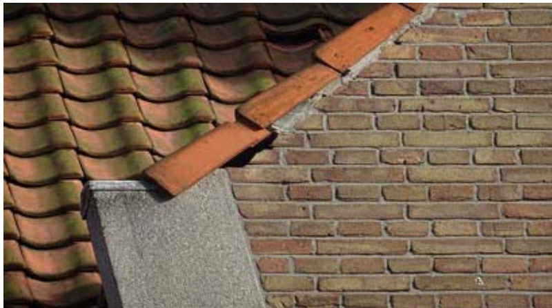
Weggeslagen betonvoeg als potentiële verblijfplaats voor Huismus of Gierzwaluw | Ecoresult B.V.
