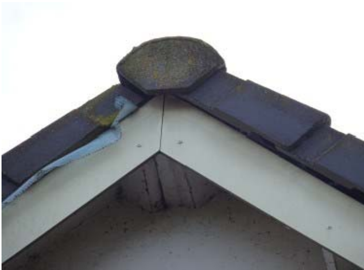
Afbeelding 5 : Openingen onder dakpannen in de daknok geschikt voor Gierzwaluw. Foto: Ecoresult B.V.
