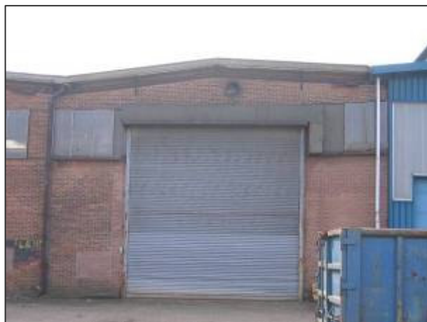
Detail noordelijke gevel. De loods is op plaatsen constructief slecht. Bovendien hebben veel aan- en verbouwingen plaatsgevonden aan de loods.
