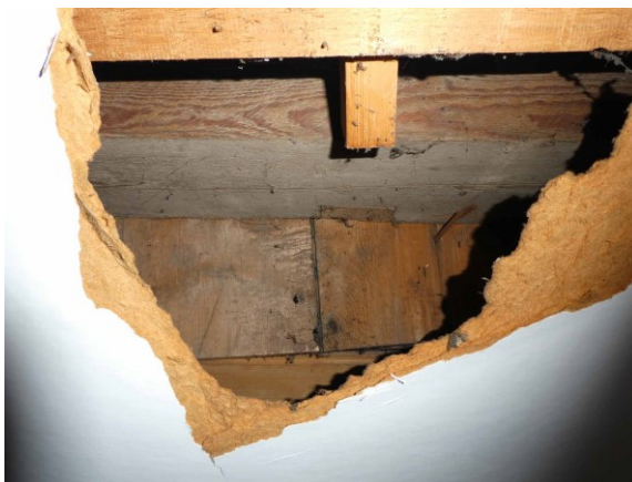
Figuur 21 Gat plafond woning
