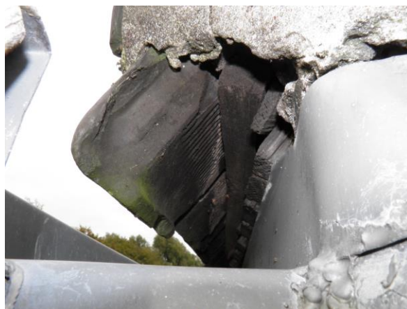
Figuur 9. De toegang onder de eerste rij dakpannen is geblokkeerd.
