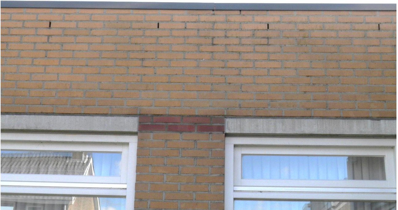
Figuur 5. Open stootvoegen boven de ramen in de gevel langs de Bizetstraat.
