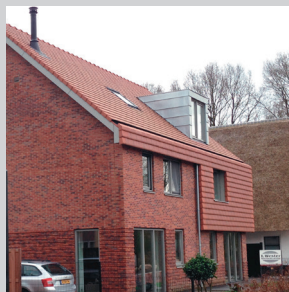
overgang dak gevel niet zwaar aangezet
