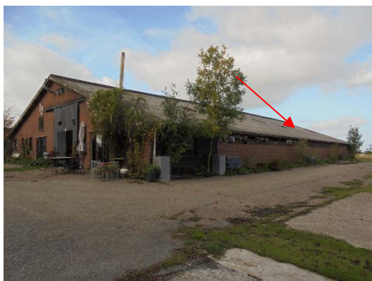
Foto 3 – bron 01, plaatmateriaal (golfplaat) Loopstal
