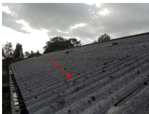
Foto 2 – bron 01, plaatmateriaal (golfplaat) Loopstal
