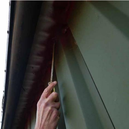
Figuur 14: Geen toegang tot de dakrand
