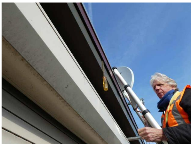
Figuur 10: Inspectie op kieren onder trespas
