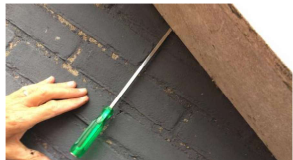
Figuur 19 Geen ruimte dakopbouw en muur
