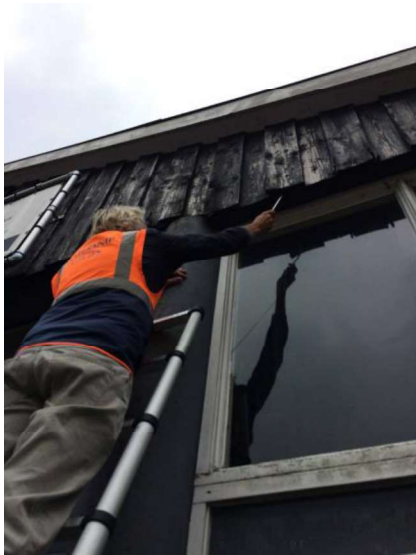
Figuur 22 Inspectie houten boeidelen
