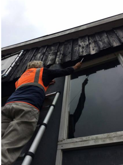
Figuur 22 Inspectie houten boeidelen
