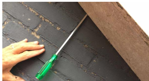
Figuur 19 Geen ruimte dakopbouw en muur
