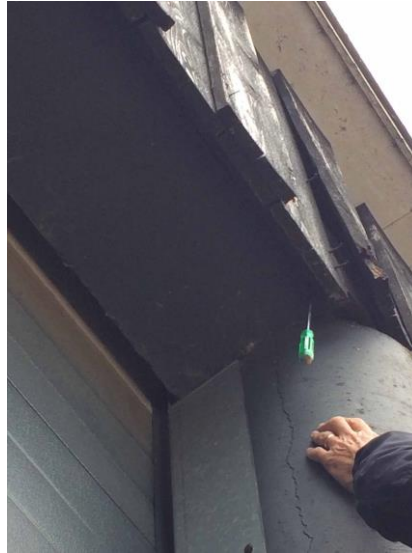
Figuur 22 Geen ruimte tussen muur en houten boeidelen
