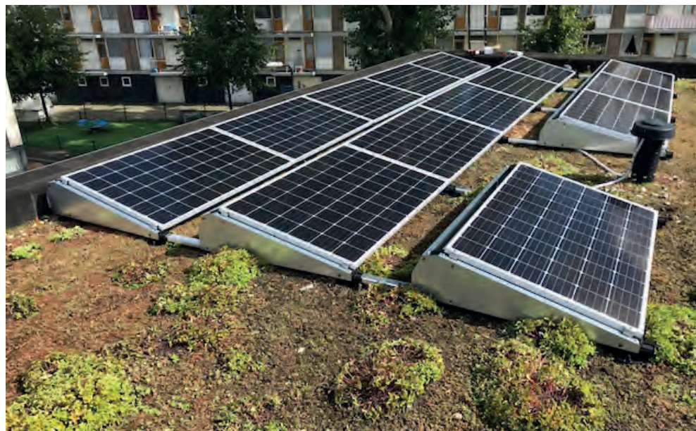
zonnepanelen op platte daken vanaf 3e verdieping en hoger
