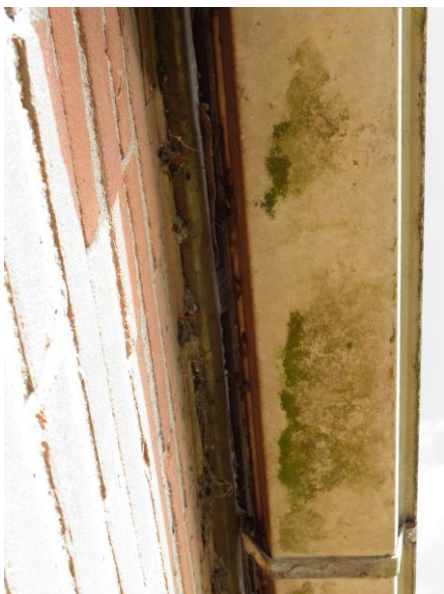
Figuur 6. Onderaanzicht van de regengoot bij het woonhuis. Er is geen ruimte tussen de muur en de goot of het dak.
