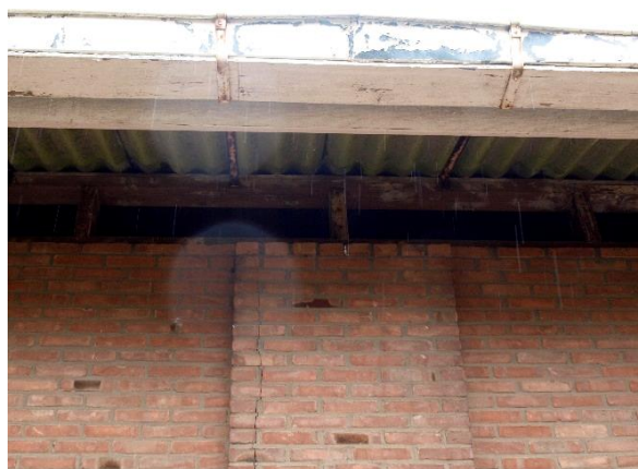
Figuur 11. De opening tussen de muur en het dak van het koelhuis is afgeschermd met gaas.
