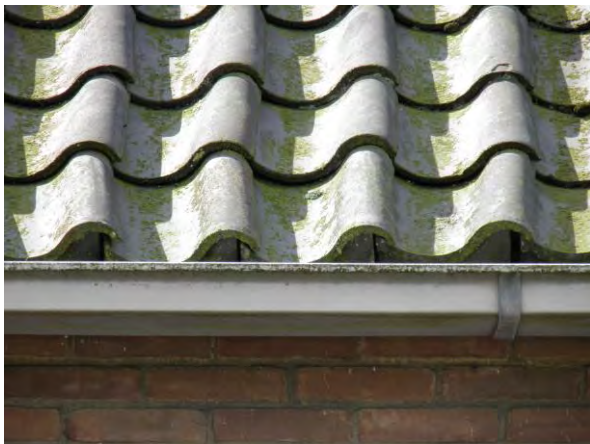
Figuur 4. De dakpannen langs de regengoot blokkeren toegang tot de binnenruimte.
