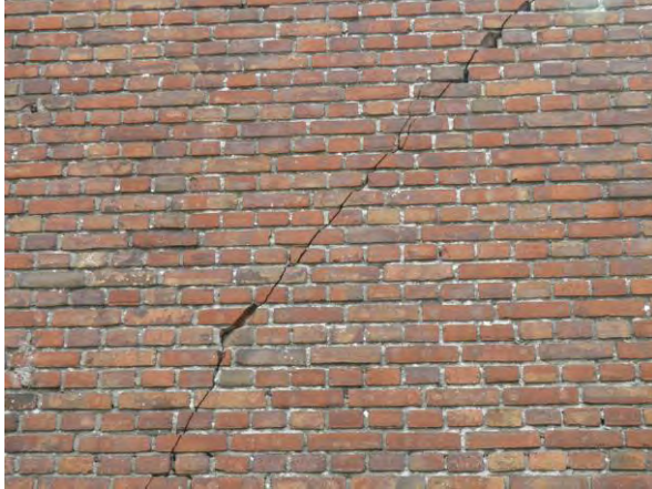
Figuur 6. In de muur zijn enkele ondiepe scheuren.
