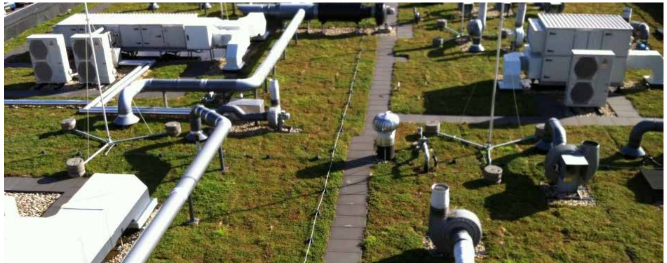
Installaties in combinatie met een sedumdak
