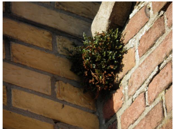
Figuur 12. Muurvaren op de muur van de woning met schuur.
