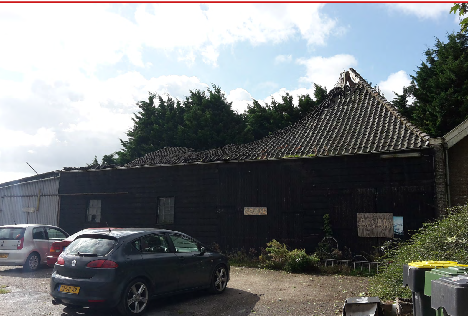
Beeldimpressie projectgebied: voorste schuur met een gedeeltelijk ingestort dak
