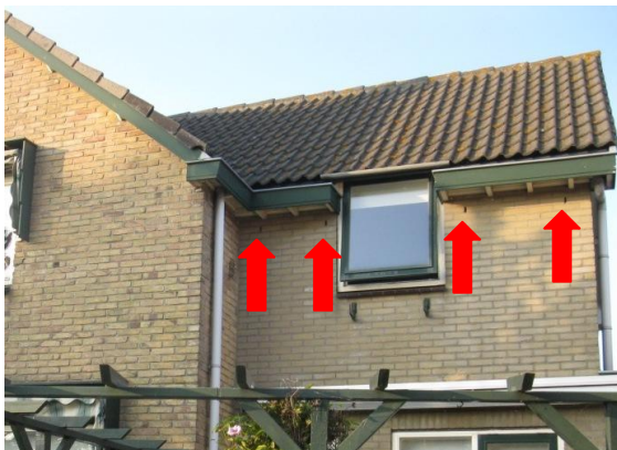
Foto 7: Spouwgoten in het woonhuis met nr. 418
