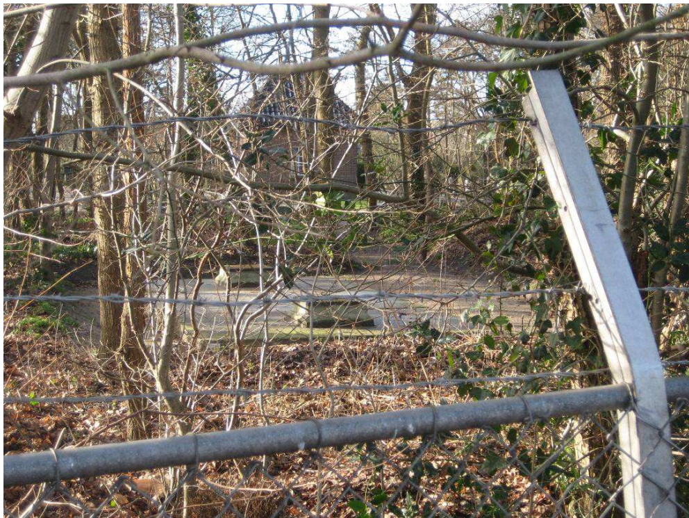
Foto 2: Mangaten van drainage van naastliggend begraafplaats, van noord naar zuid gekeken
