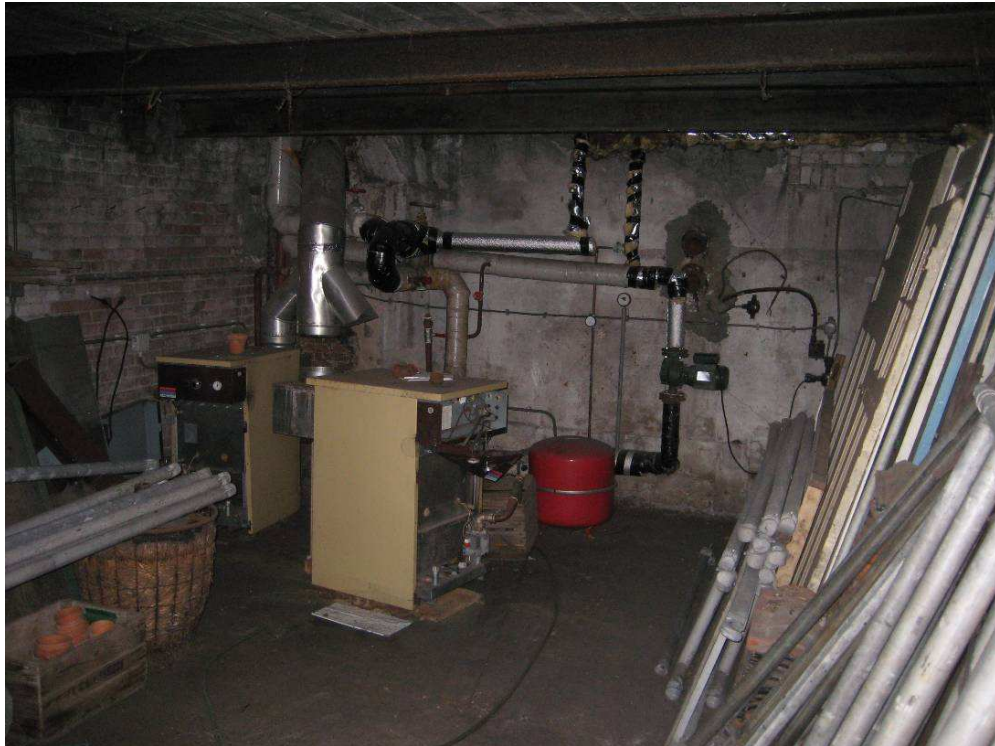
Foto 5: Ruimte in kelder met ketelsysteem
