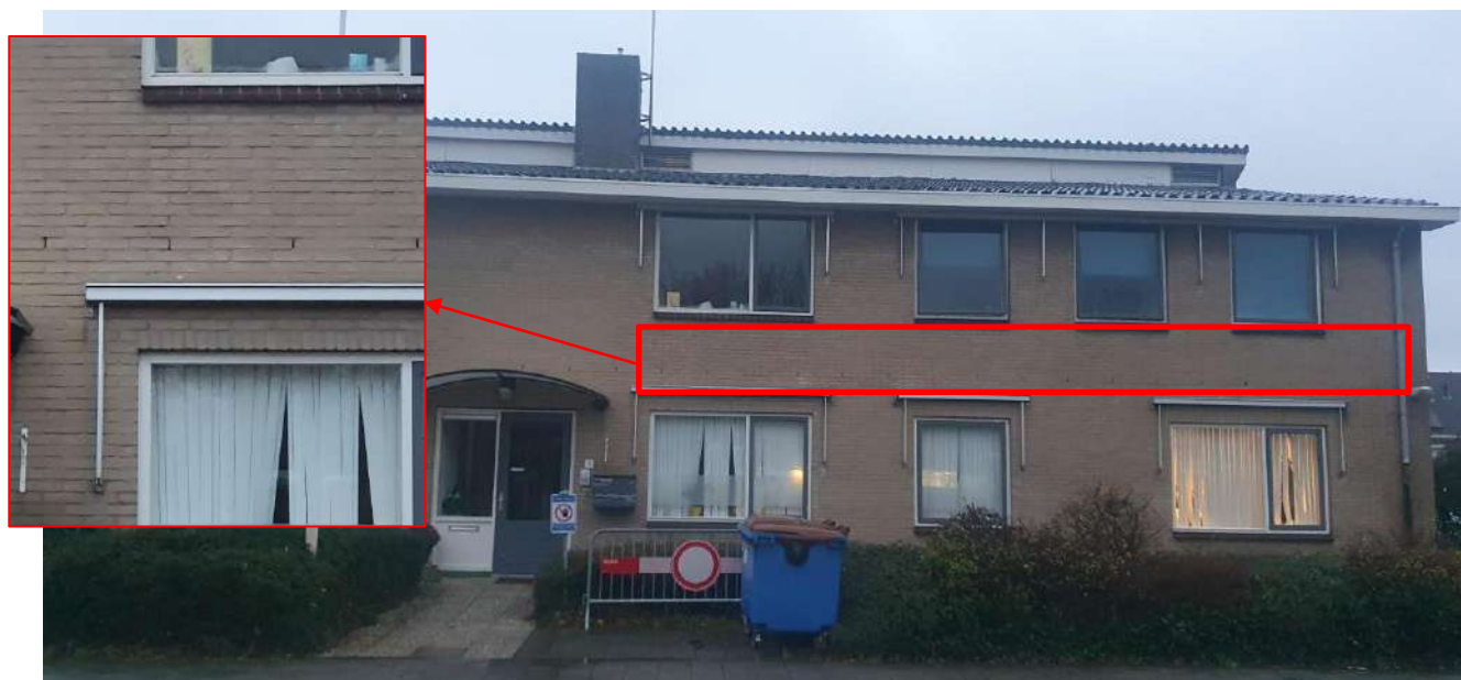
Figuur 20: Open stootvoegen bij wooncomplex Dijkzicht 1.
